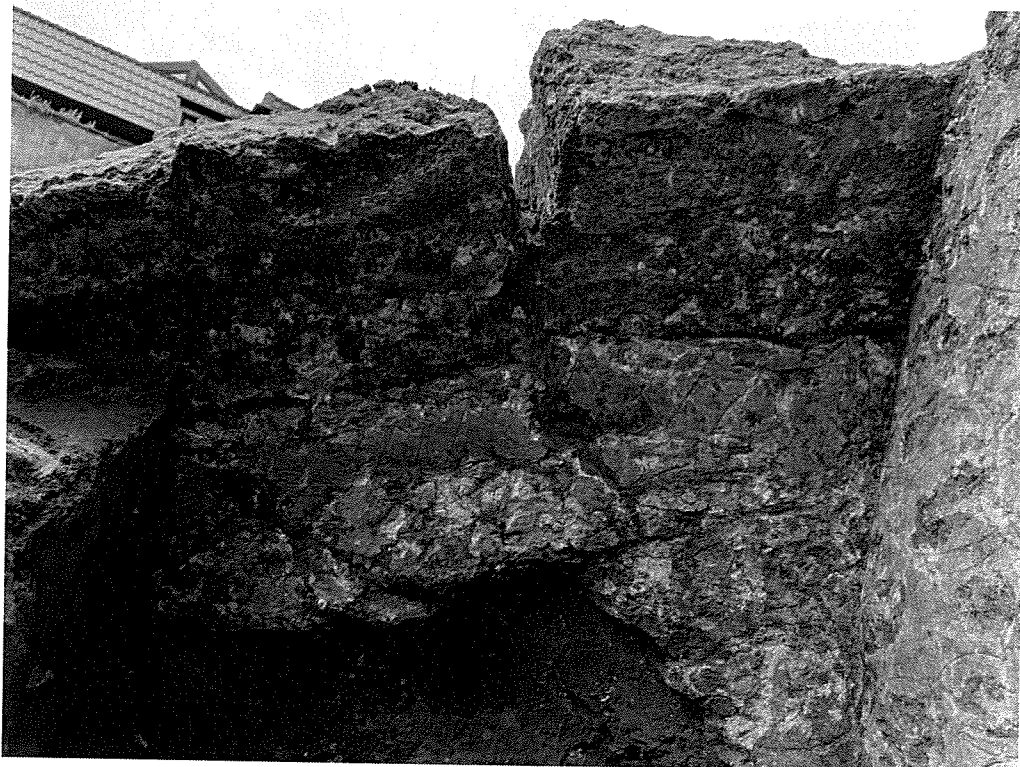
24. Hipogeu – detaliu boltă fracturată
